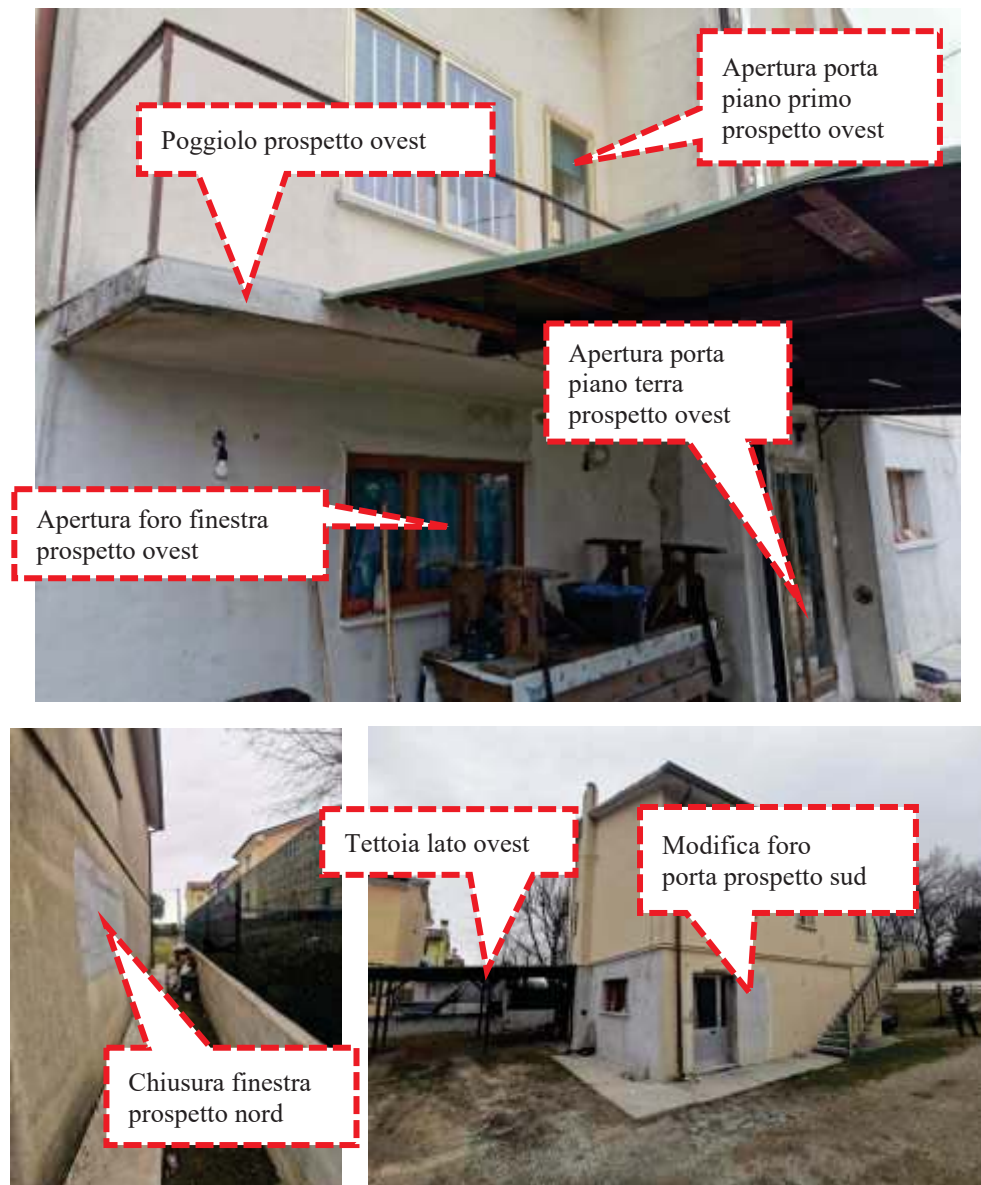
Foto n. 5 _ Panoramiche esterne con indicazione delle difformità
