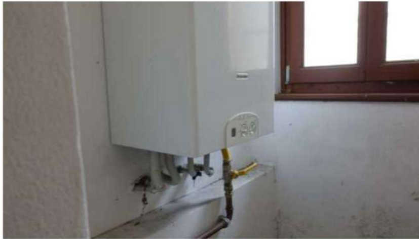
Vista ripostiglio con caldaia
