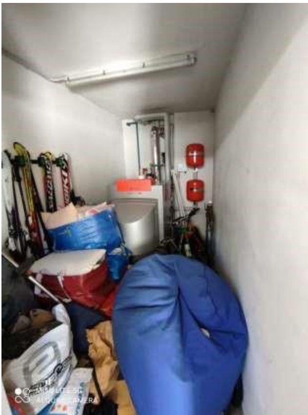
Foto 09: PS1 locale centrale termica
