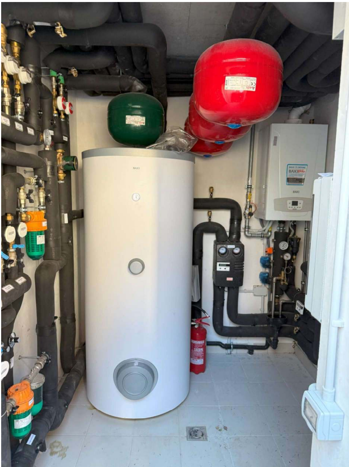
Foto 17: centrale termica comune (particella .844 sub 18 ex sub. 15)
