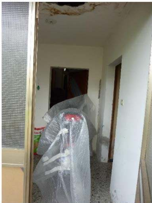
Corridoio ingresso ove si nota il Parziale crollo del soffitto.
